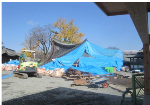
上は、倒壊した阿蘇神社の楼門です。拝殿は撤去され、復旧工事が始まっていました。右下の写真は、豊肥線立野駅近くの墓地です。中に入って行けないくらいの惨状です。
